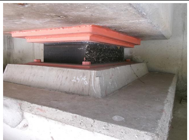
역동교 교량받침 A2-SH3 무수축물탈 박락 0.1*0.1
