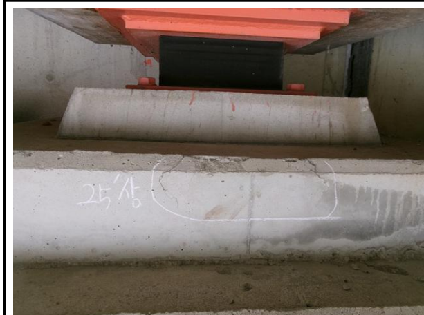
역동교 교량받침 A2-SH4 받침콘크리트 충분리 0.3*0.1
