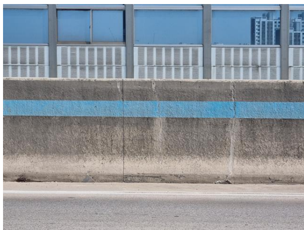
역동교 이천방향 방호벽 S1 중분대 균열 0.3/1.0*3EA_신규
