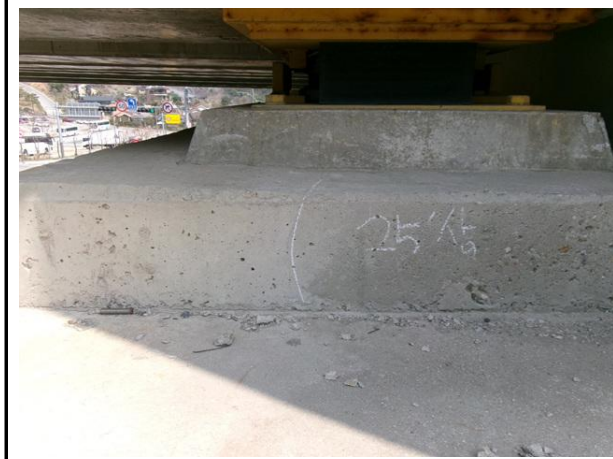
역동교 교량받침 A1-SH4 받침콘크리트 균열 0.1/0.3
