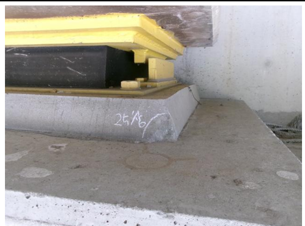
역동교 교량받침 A2-SH7 무수축물탈 파손 0.1*0.1
