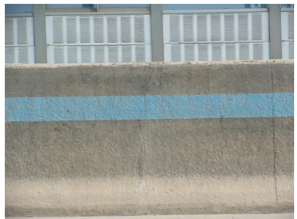
역동교 이천방향 방호벽 S1 중분대 균열 0.3/1.5_신규
