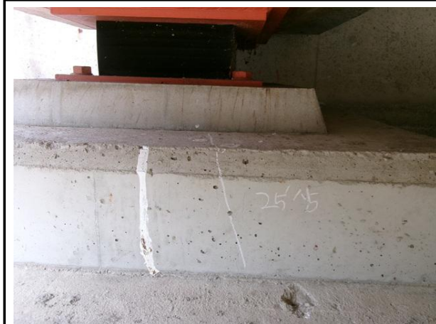
역동교 교량받침 A2-SH1 받침콘크리트 균열 0.1/0.3
