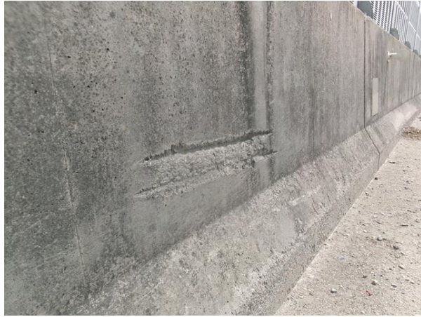
역동교 수원방향 방호벽 S1 긁힘 0.2*0.8_신규
